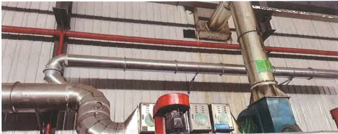
本项目油烟净化处理设备
